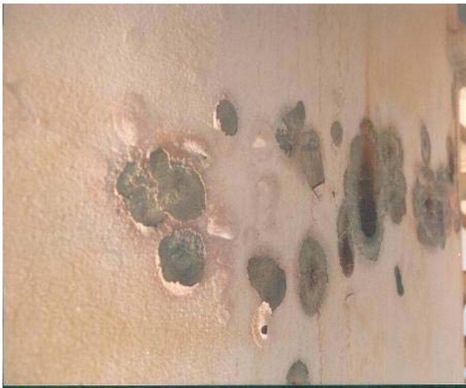
عکس شماره ۱ زنگزدگی پوشش سطوح مخزن ۲/۰۰۰/۰۰۰ لیتری آب صنعتی در عملویه در کمتر از شش ماه
