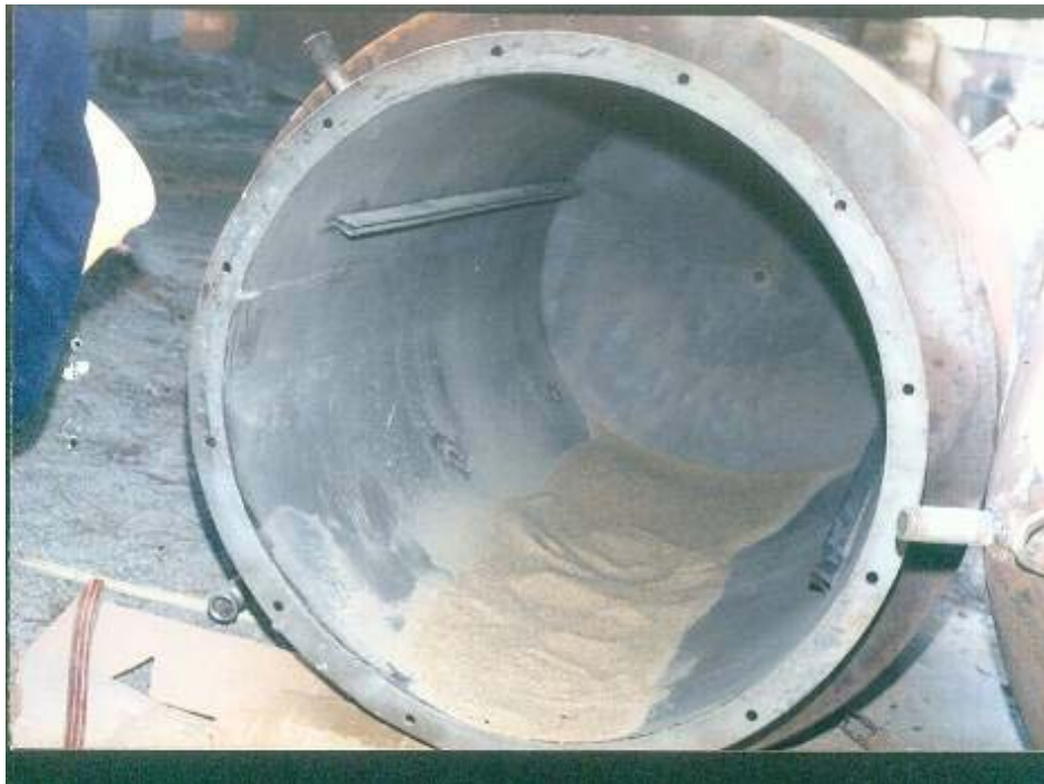
عکس شماره ۱۵-۱۳: اکتفا به انجام عملیات بلاستینگ و عدم توجه به رفع سایر موانع از قبیل جوش های نامناسب، لبه های تیز، طراحی نامناسب و ...
